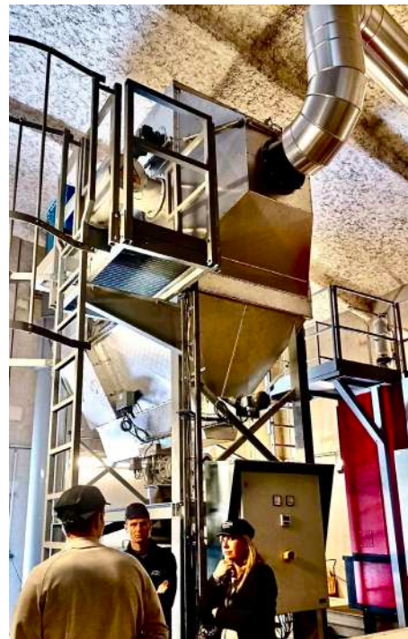
Filtre à particules électrostatique ou électrofiltre - Chaufferie bois du lycée Jean Rostand à Chantilly (60) exploitée par ENGIE Solutions →
