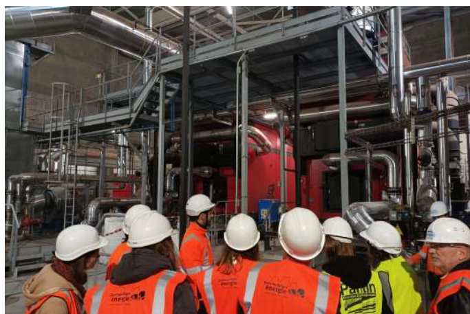
Visite de la chaufferie de Gennevilliers dans le cadre de la plénière bois-énergie.
