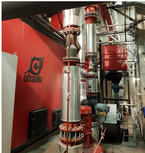
Chaudière à bois de la Ville de Saint-Germain-en-Laye
