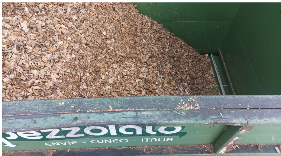
Silo à bois déchiqueté d'une petite chaudière
