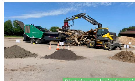
Plateforme bois énergie
